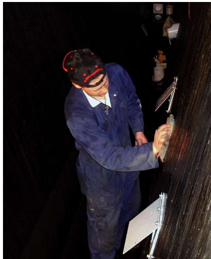
Bild 4 • Montage der Absaugstutzen in der Sammelwanne der Filterpresse. Abweiser verhindern, dass der Filterkuchen direkt in die Absaugstutzen gelangt. Die Person verdeutlicht die Abmessungen der Sammelwanne.
