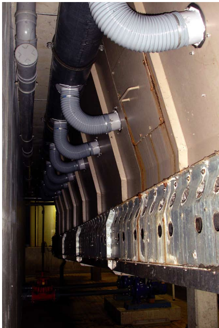
Bild 3 • Sammelwanne mit automatischer Austragsvorrichtung unterhalb der Kammerfilterpresse. Gut erkennbar sind die Absaugstutzen, über die in der Sammelwanne ein Unterdruck erzeugt wird.
