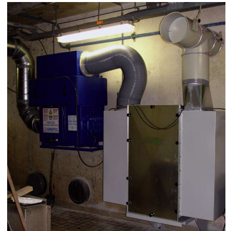
Bild 5 • Eines der eingesetzten Hochleistungsluftfiltergeräte vom Typ UNIFIL® während der Montage. Gut erkennbar ist die nachgeschaltete Gassorptionsfilterstufe (rechts im Bild). Je nach Jahreszeit kann die gefilterte Luft entweder nach außen abgeleitet oder in den Arbeitsraum zurückgeführt werden.
