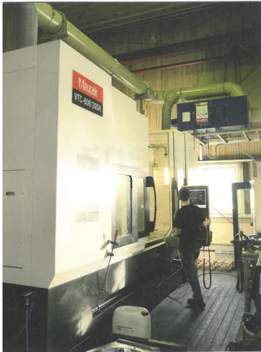
2 Über zwei Absaugpunkte gelangt ölnebelhaltige Luft aus dem Maschinenraum zum Elektrofilter. Der Bediener kann sofort nach Taktende die Tür öffnen
